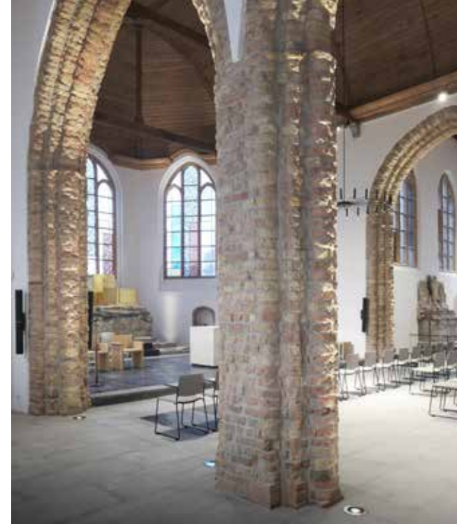
De tongewelven zijn gereconstrueerd met behulp van eikenhouten beplanking, gesculpteerde houten consoles en middenstijlen, enzovoort. “Een uniek werk waar onze timmermannen zes maanden lang fulltime mee aan de slag zijn geweest”, aldus Jan De Moor.
